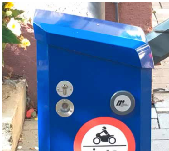
Abb. 7: elektrische Schranke mit Feuerweherschließung der Stadt Rüsselsheim
