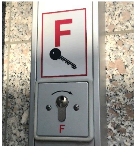
Abb.2 – elektrisch betriebene Sperreinrichtung
